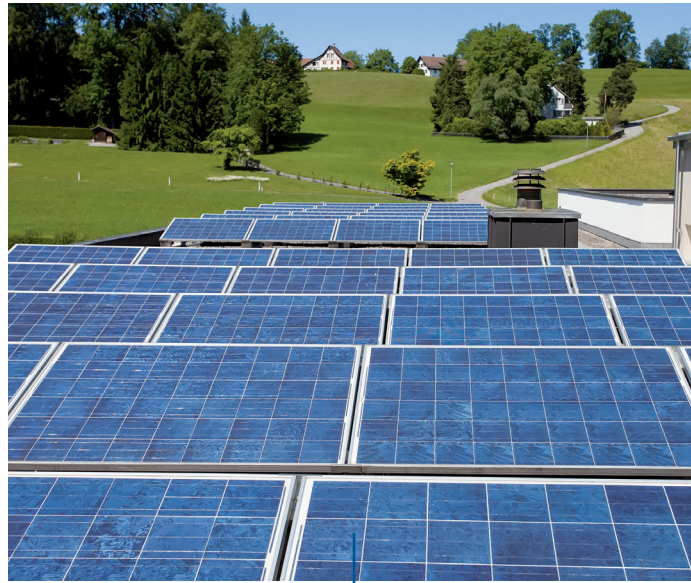
Photovoltaikanlagen auf dem EWJR-Werkgebäude
